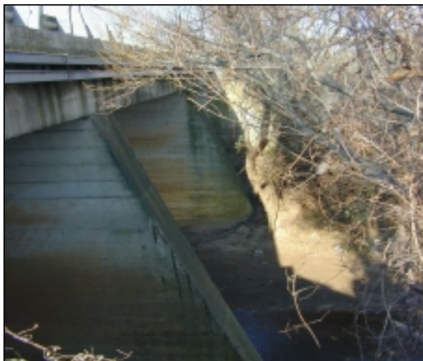
figura 1.24 – Tafone: ponte di via Aurelia – vista da monte
